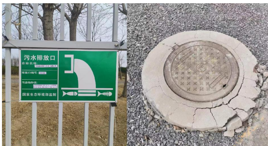
图7 生活废水 DW002 排放口标识牌及排口
