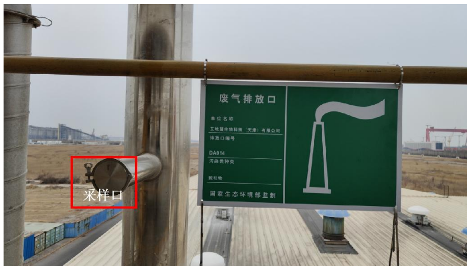
图4 废气排气筒及废气排口标识
