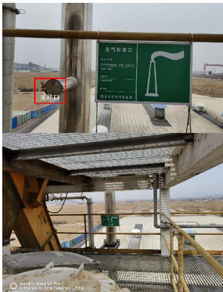
图 5 DA014 排气筒采样口与标识牌
