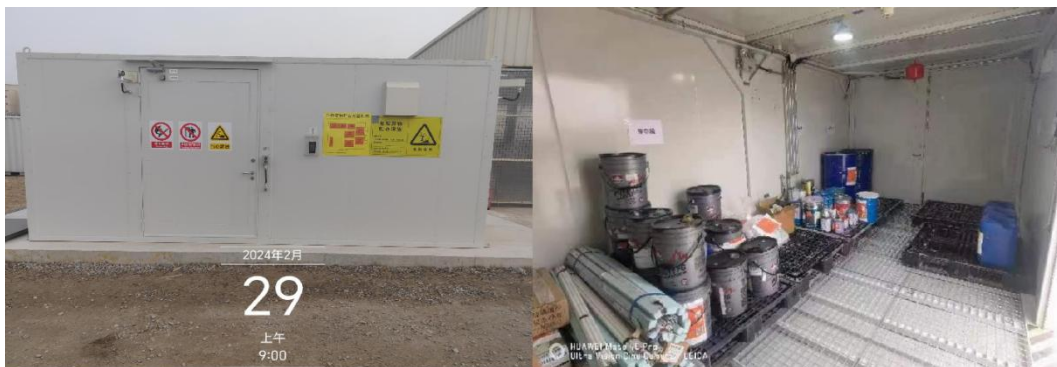
图8 危废暂存间环保标志牌及危废暂存间
