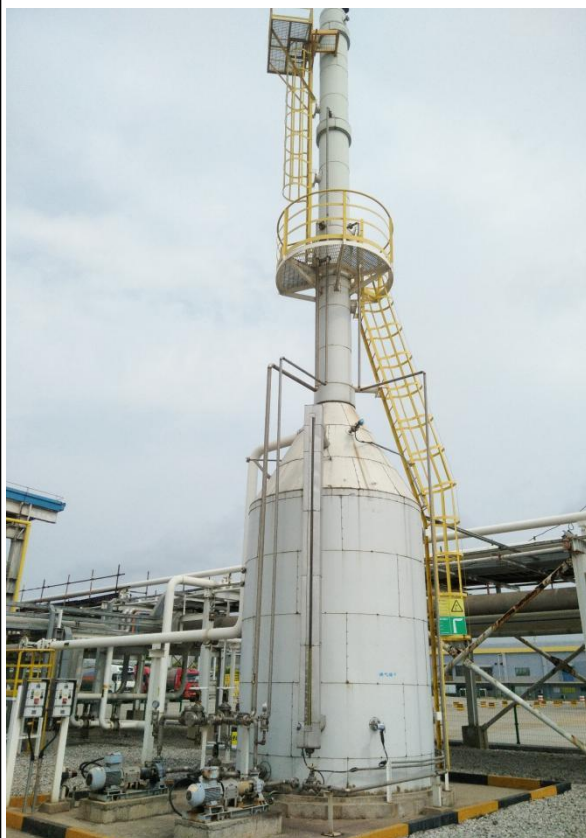
水洗喷淋排气筒
