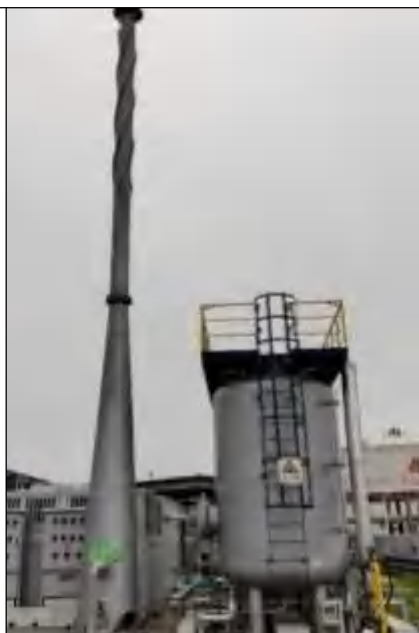
DA032(DA040) (专用罐区) (照片为标识牌、 排气口 (采样平 台))
