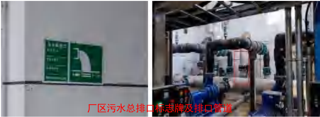
PVC 车间排污口标志牌及排口管道
