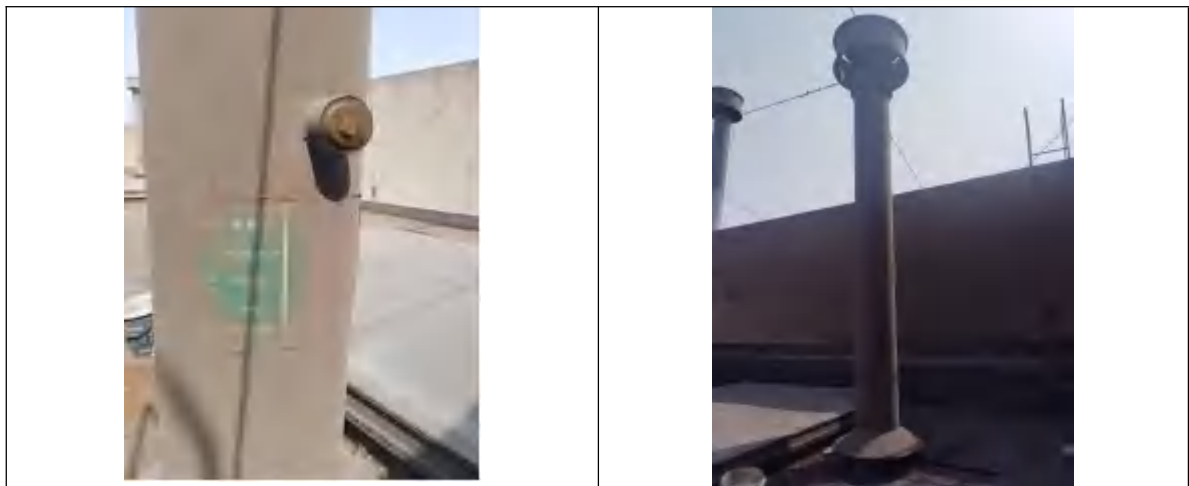
排气筒P 141 及标识牌
