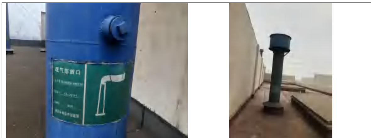
排气筒P 144 及标识牌
