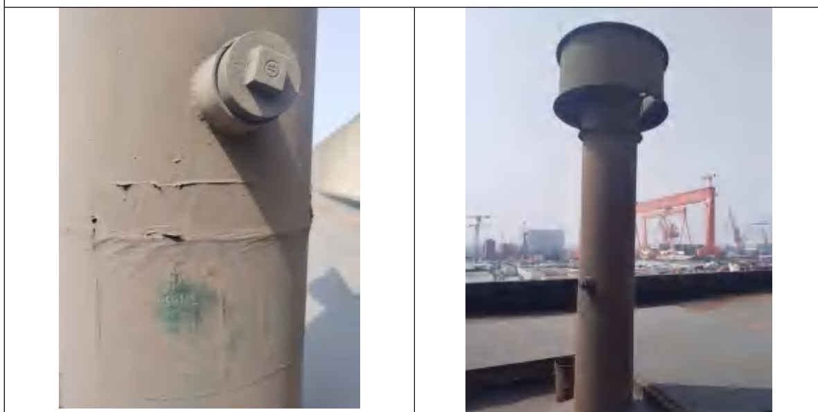
排气筒P 139 及标识牌
