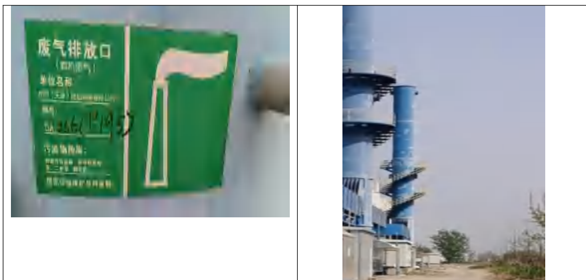
排气筒P 127/128 及标识牌 (实际为P 195 )
