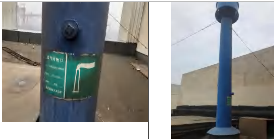
排气筒P 142 及标识牌
