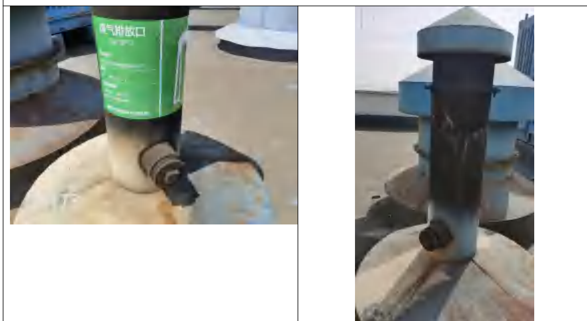
排气筒P 173 及标识牌
