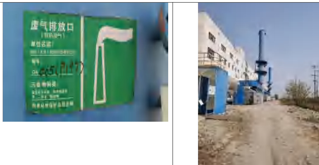
排气筒P 119/120 及标识牌（实际为P 197 ）
