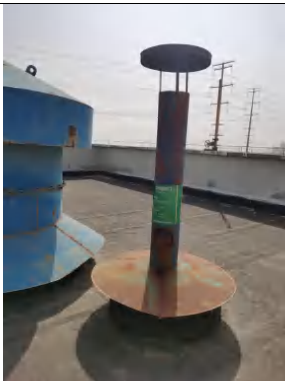
排气筒P 200 及标识牌
