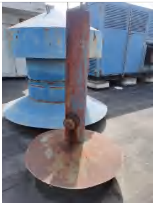
排气筒P 198 及标识牌
