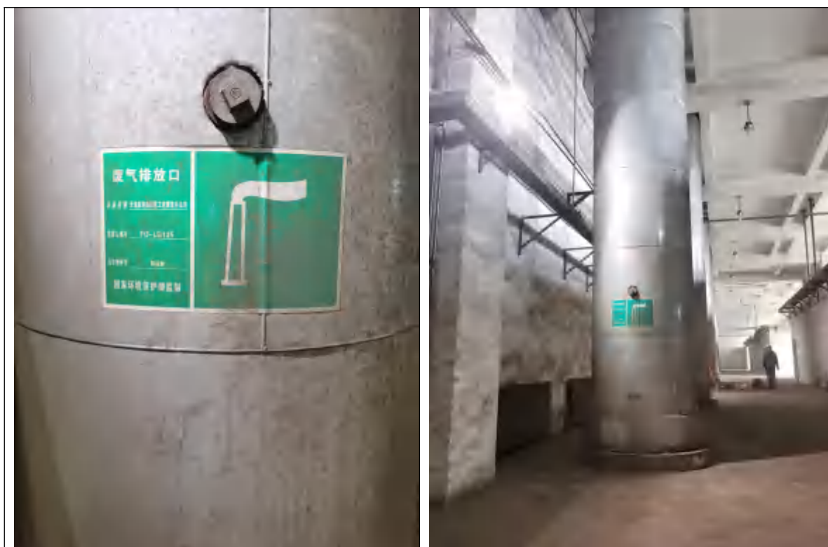
排气筒P 135 及标识牌
