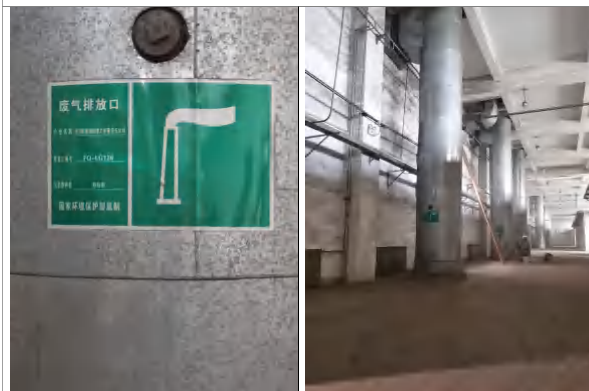
排气筒P 136 及标识牌
