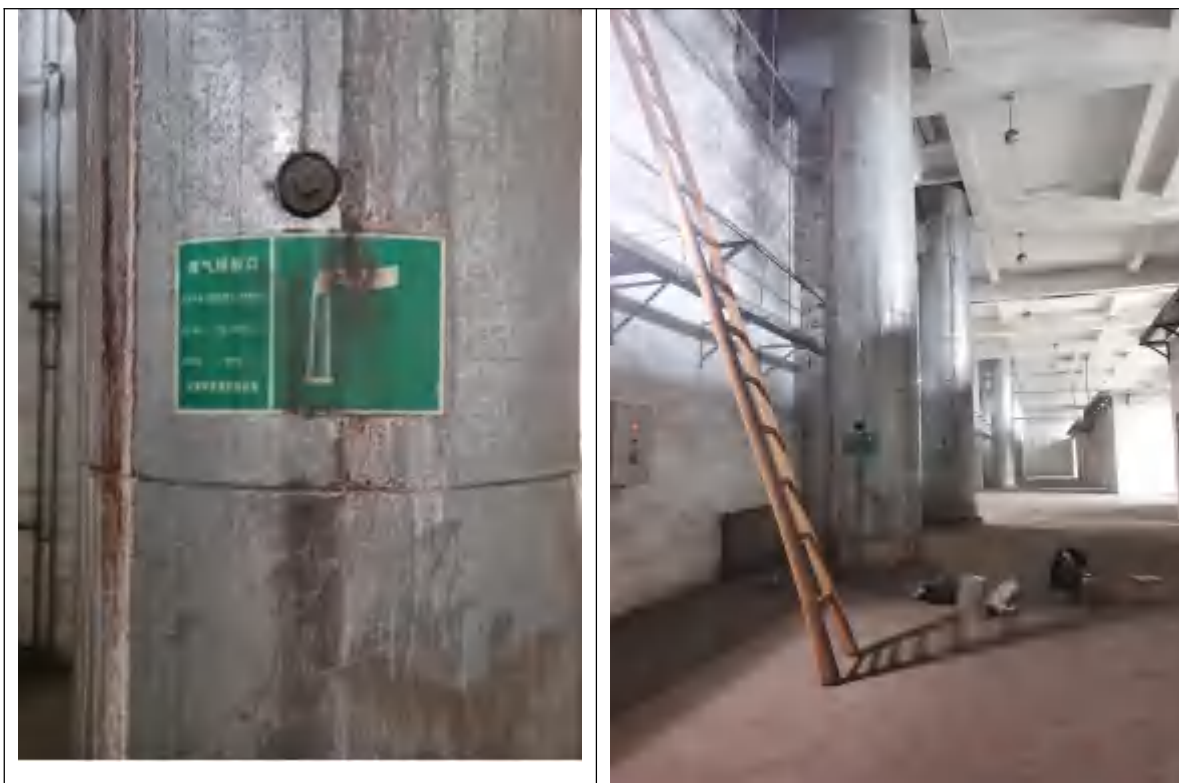
排气筒P 137 及标识牌
