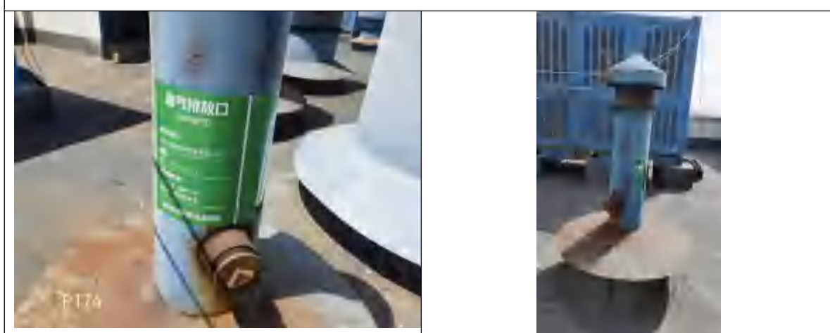
排气筒P 174 及标识牌
