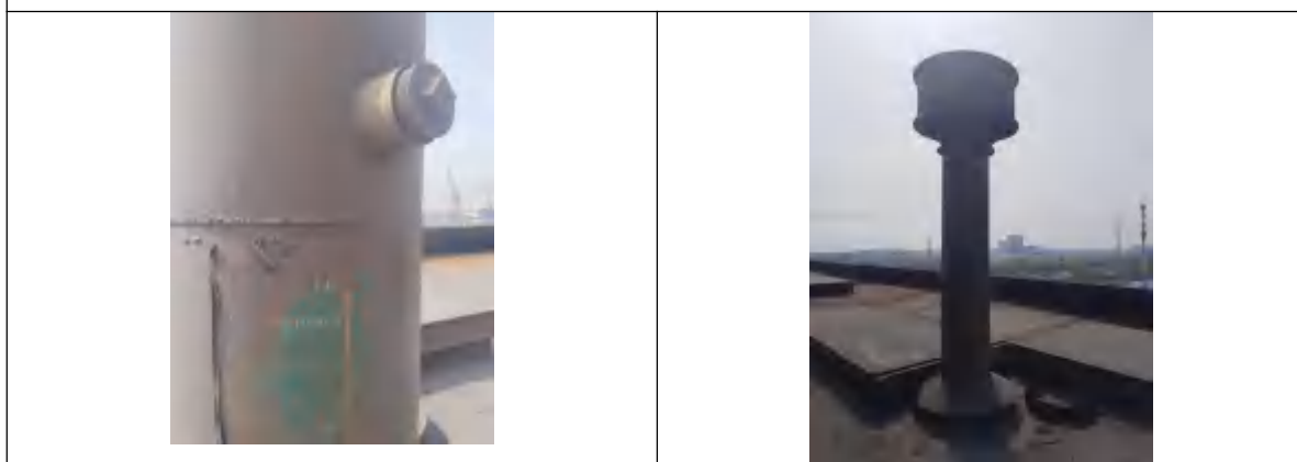
排气筒P 140 及标识牌
